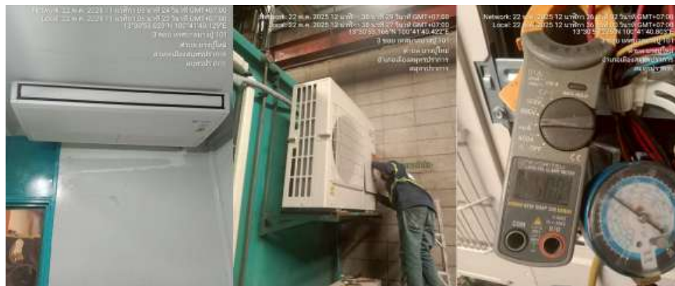
หลังทำการปรับปรุง (หลังทำการเปลี่ยนแอร์และตรวจวัด)
