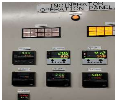
ก่อนปรับปรุง (ก่อนปรับอุณหภูมิ)
